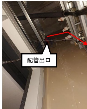
18階共有部EPS-JT-3(1)内
