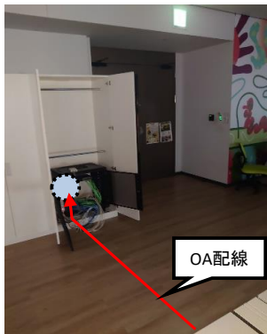
ONU設置箇所
